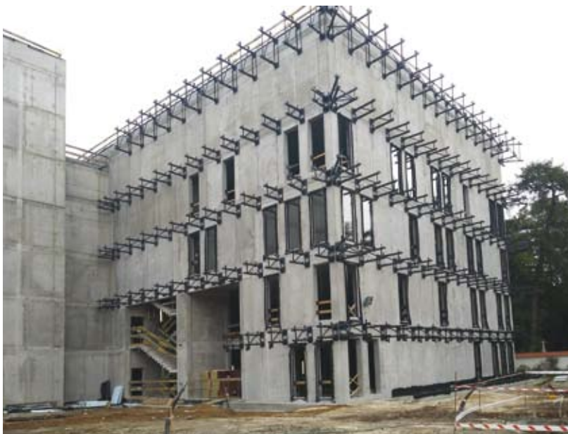
23. Budowa nowej siedziby Archiwum Narodowego w Krakowie. Segment biurowy wraz z podkonstrukcją do szklanej fasady, stan z października 2018 r. (fot. Paweł Ząbczyński)
