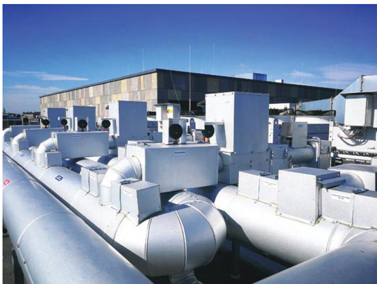
54. Budowa nowej siedziby Archiwum Narodowego w Krakowie. Dach segmentu biurowego – instalacje klimatyzacji precyzyjnej dla serwerowni, stan z kwietnia 2020 r. (fot. Paweł Ząbczyński)
