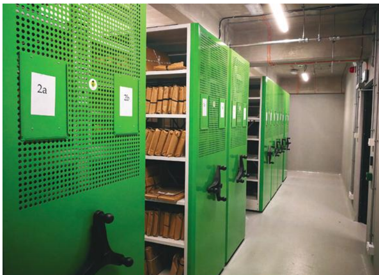
56. Budowa nowej siedziby Archiwum Narodowego w Krakowie. Regały przesuwne zamontowane w magazynach, stan z grudnia 2020 r. (fot. Paweł Ząbczyński)
